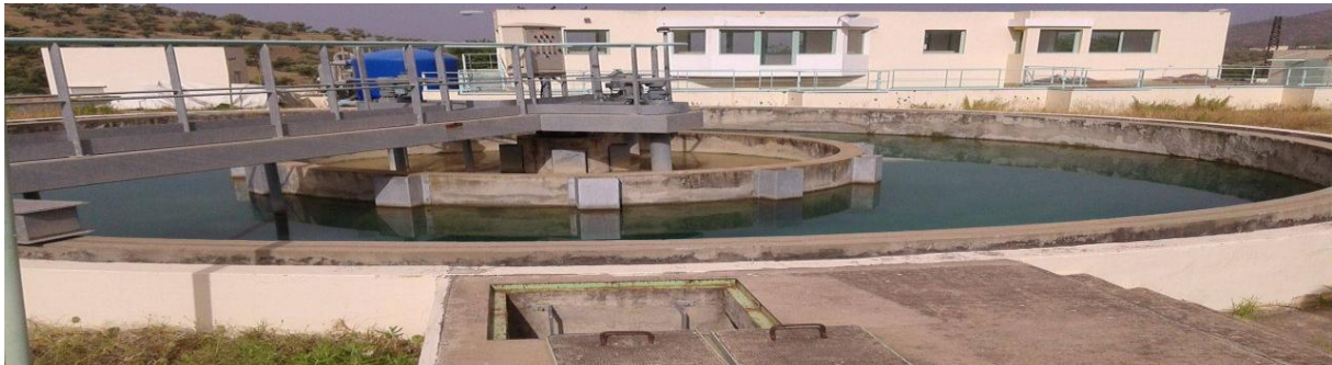
Image 6 : bassin permettant la décantation
