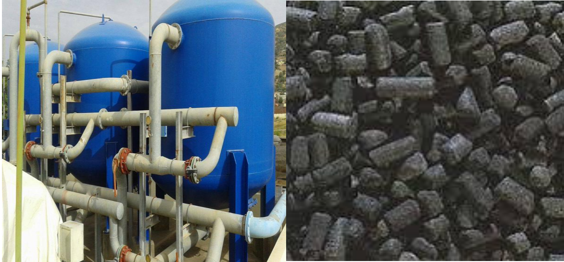
Image 8 : les cuves de la filtration par le charbon actif en grain
