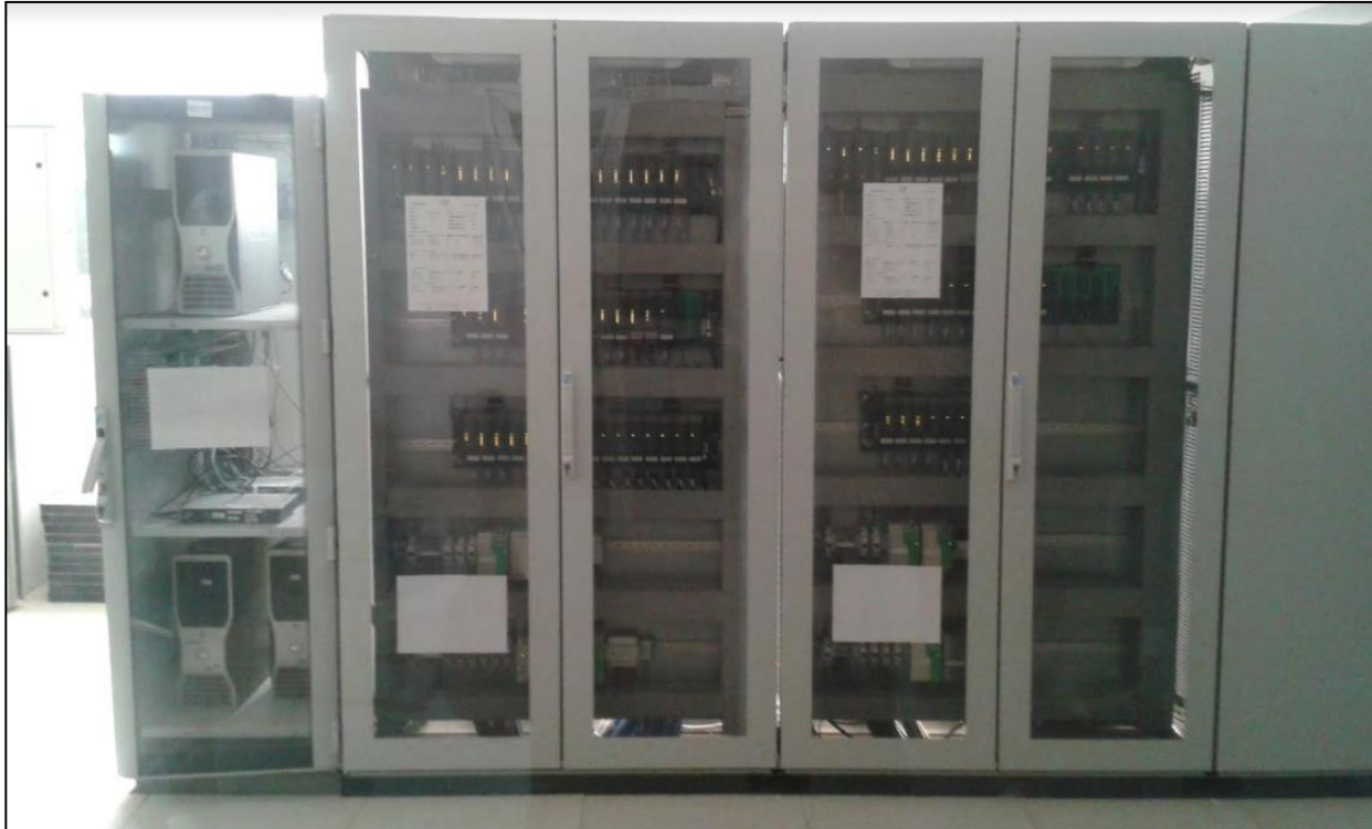
Figure 24 : Post du système DELTAV de la ligne H
