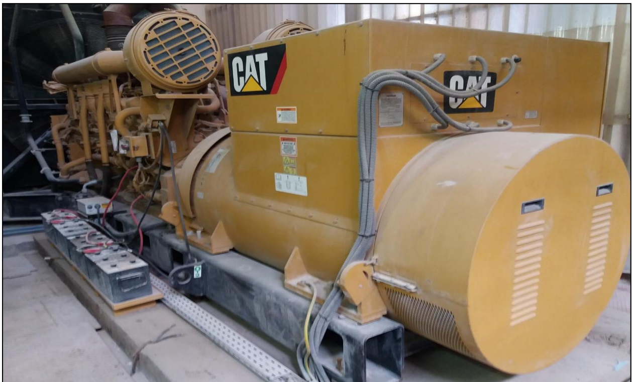
Figure 20 : Le groupe électrogène GE1 de la centrale de MP1.
