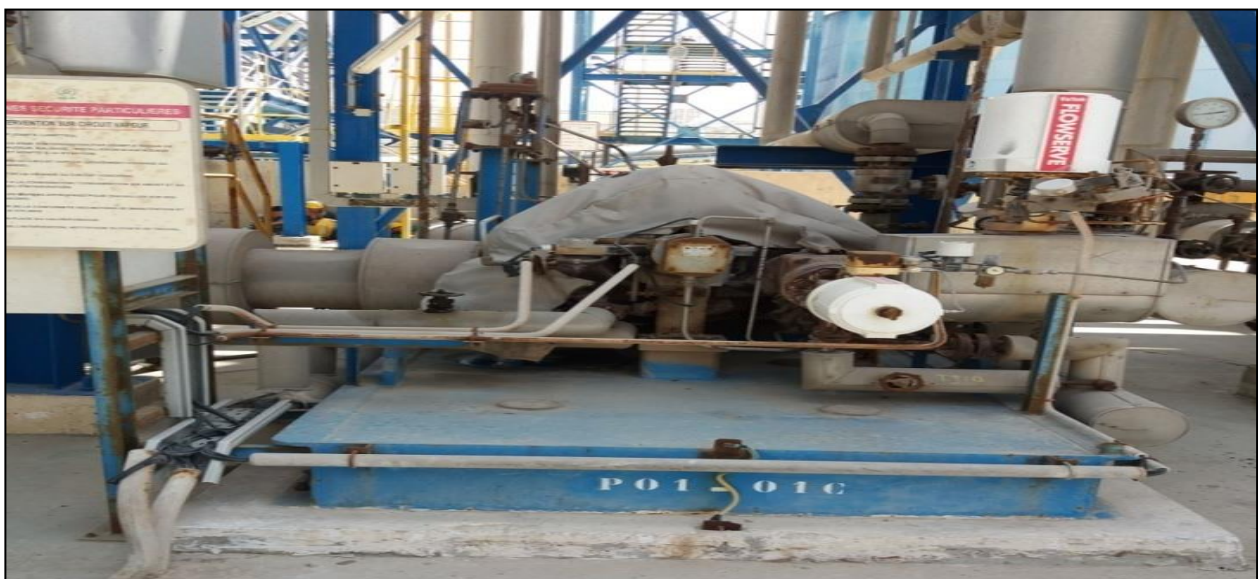
Figure 10 : Dos du groupe turbopompe P-01-01C de la ligne H.
