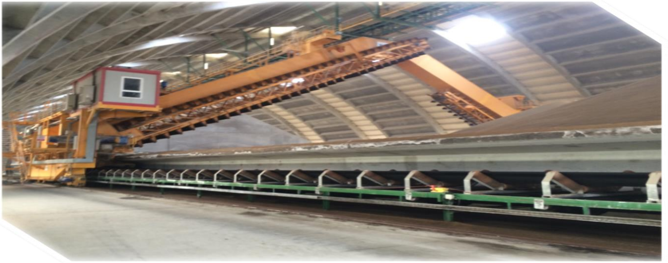
Figure 6: Vue sur le grappeur du hangar HE6
