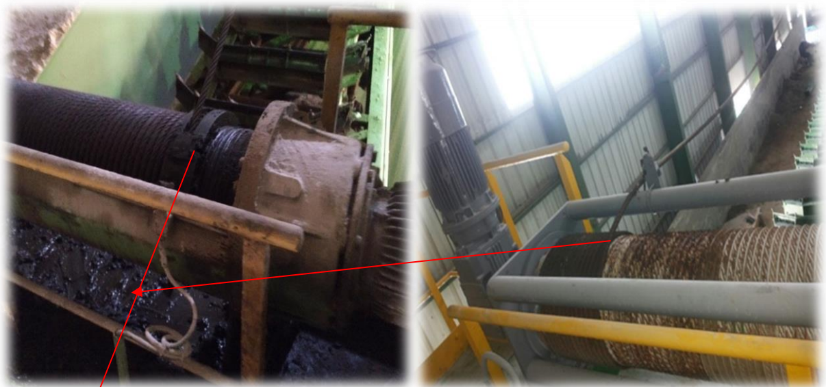
Figure 13: Vue sur les treuils de levage des bras du gratteur
