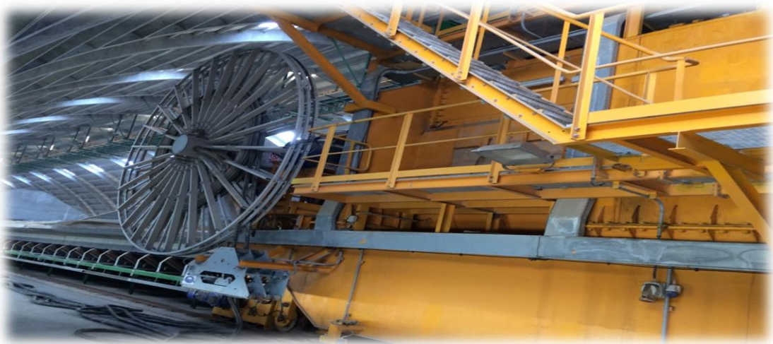
Figure 14: Vue sur l'enrouleur du câble du gratteur
