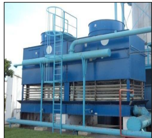
Figure 8: Tours de refroidissement
