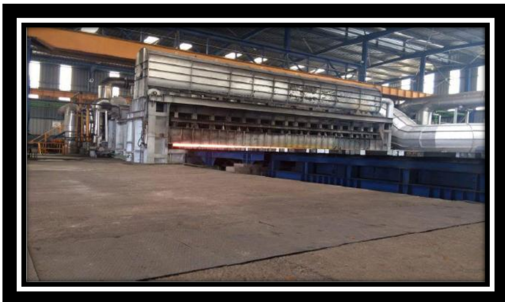
Figure 5: Four de réchauffage
