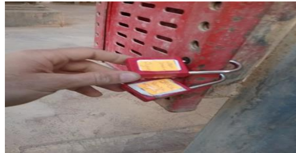
FIGURE 27:CADENAS DE CONSIGNATION DU BROYEUR
