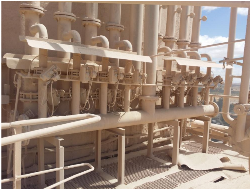
Figure 21 : les électrovannes du silo d'humidité
