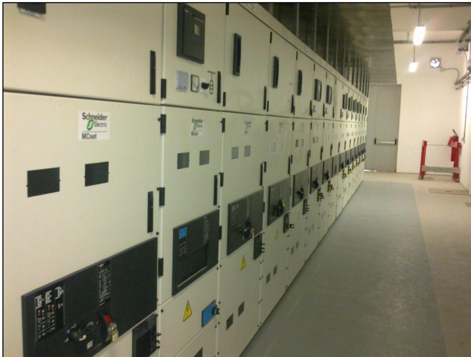
Figure 25 : Salle MT de la centrale Maroc Chimie.
