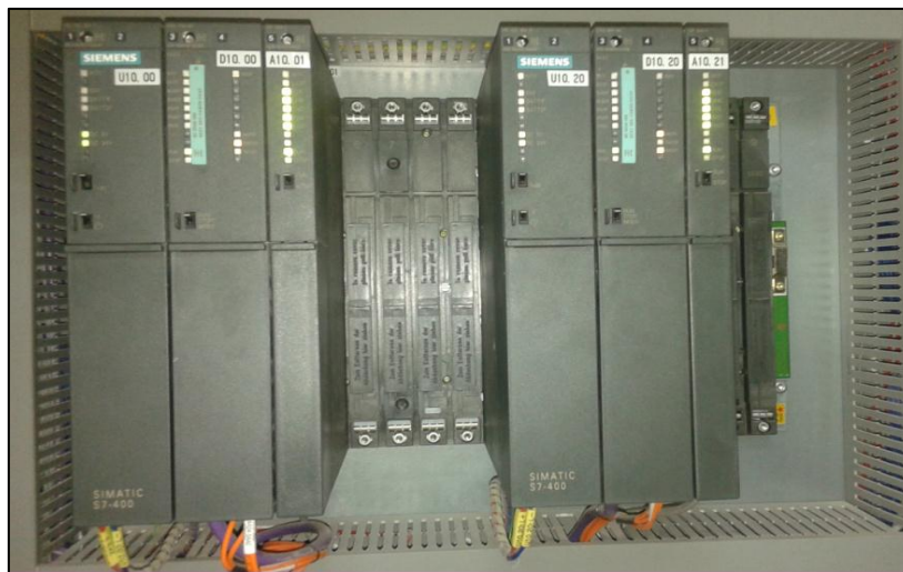
Figure 7 : Système automatisé siemens S7-400H.
