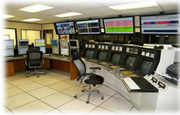
Figure 5 : La salle de contrôle
