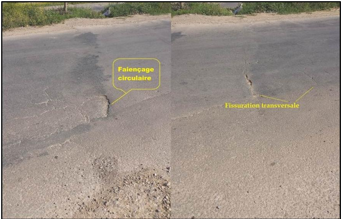
Figure I.3 : Formes de dégradation sur la route (RN8).
