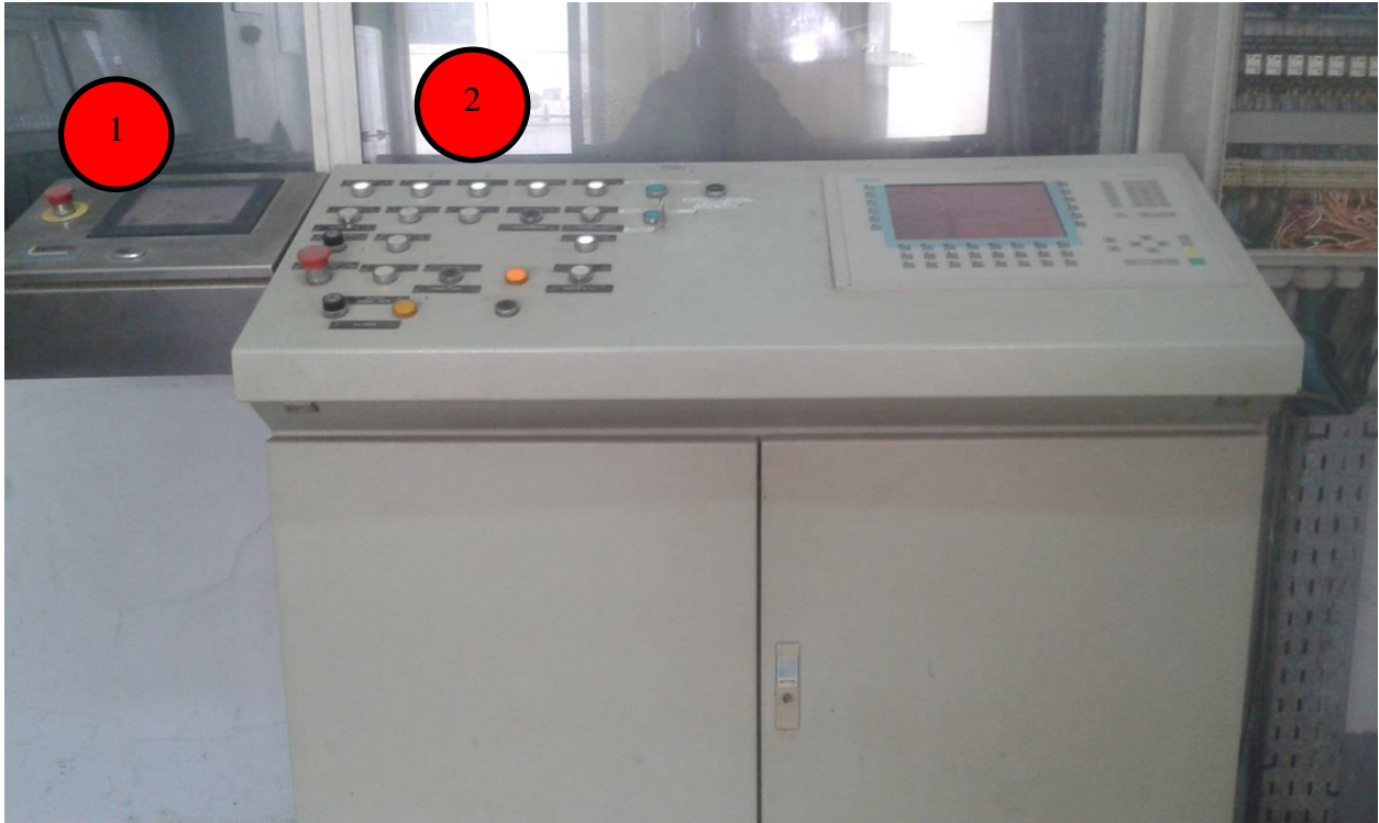
Figure 36: Poste de commande d'axe
