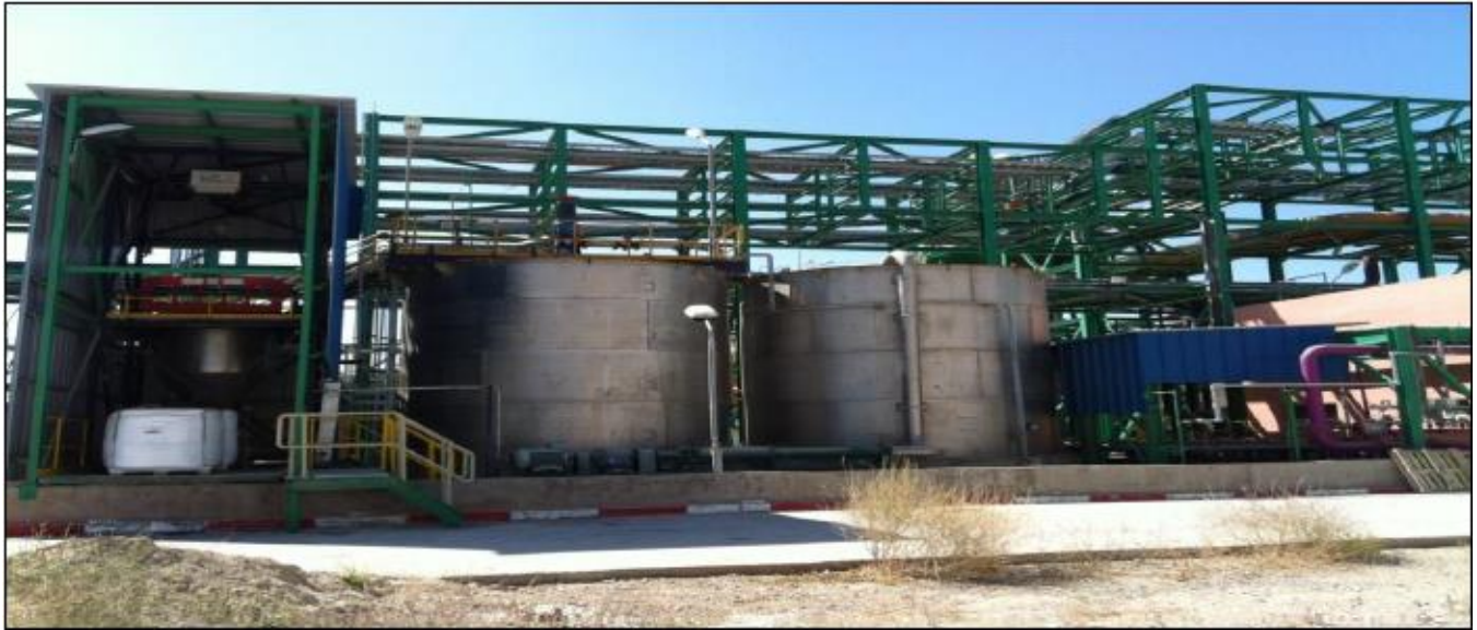
Figure 19 : Zone de floculation
