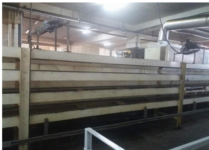
Figure 6 : convoyeur de refroidissement
