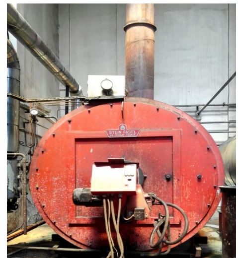
Figure 4 : Chaudière à fioul
