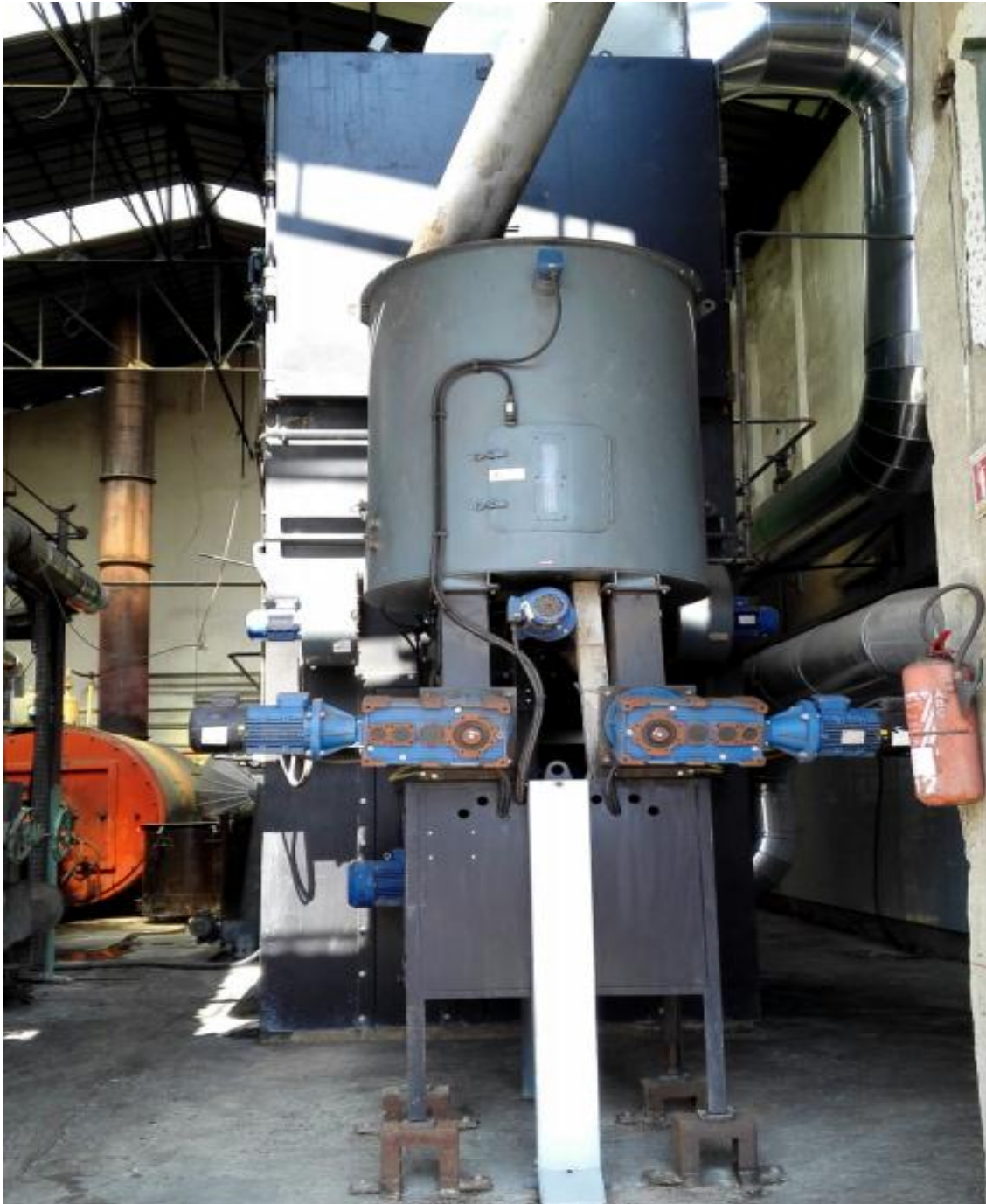
Figure 7 : Chaudière à grignon
