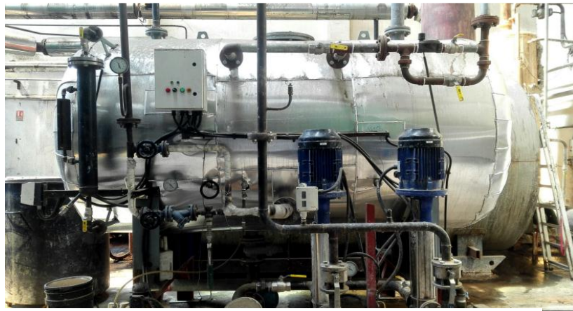
Figure 11: La bâche d'eau
