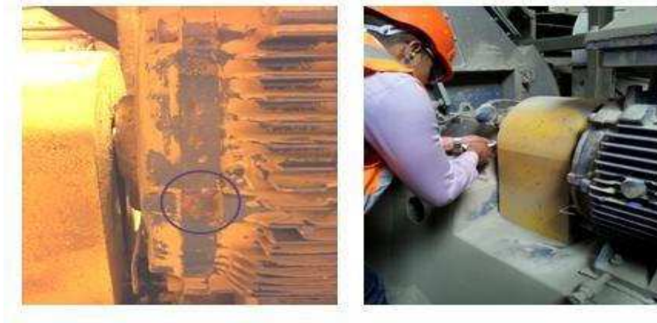
Figure 22: Repérage des points de mesure de ventilateur du refroidisseur V6
