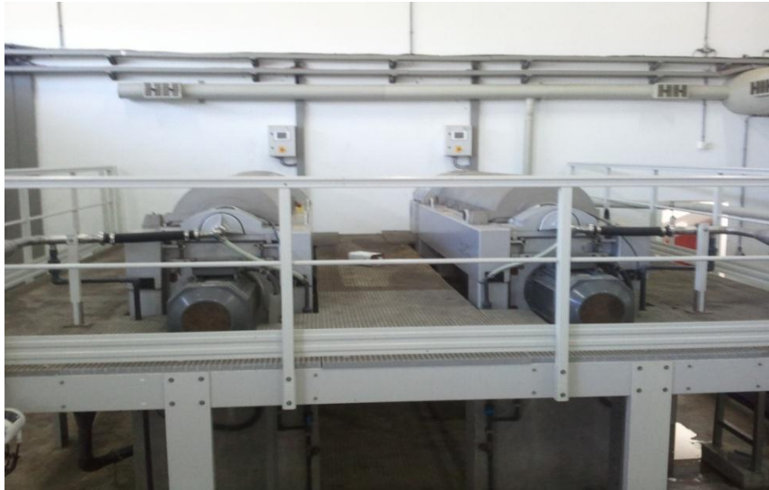
Figure 12: centrifugeuses pour déshydratation
