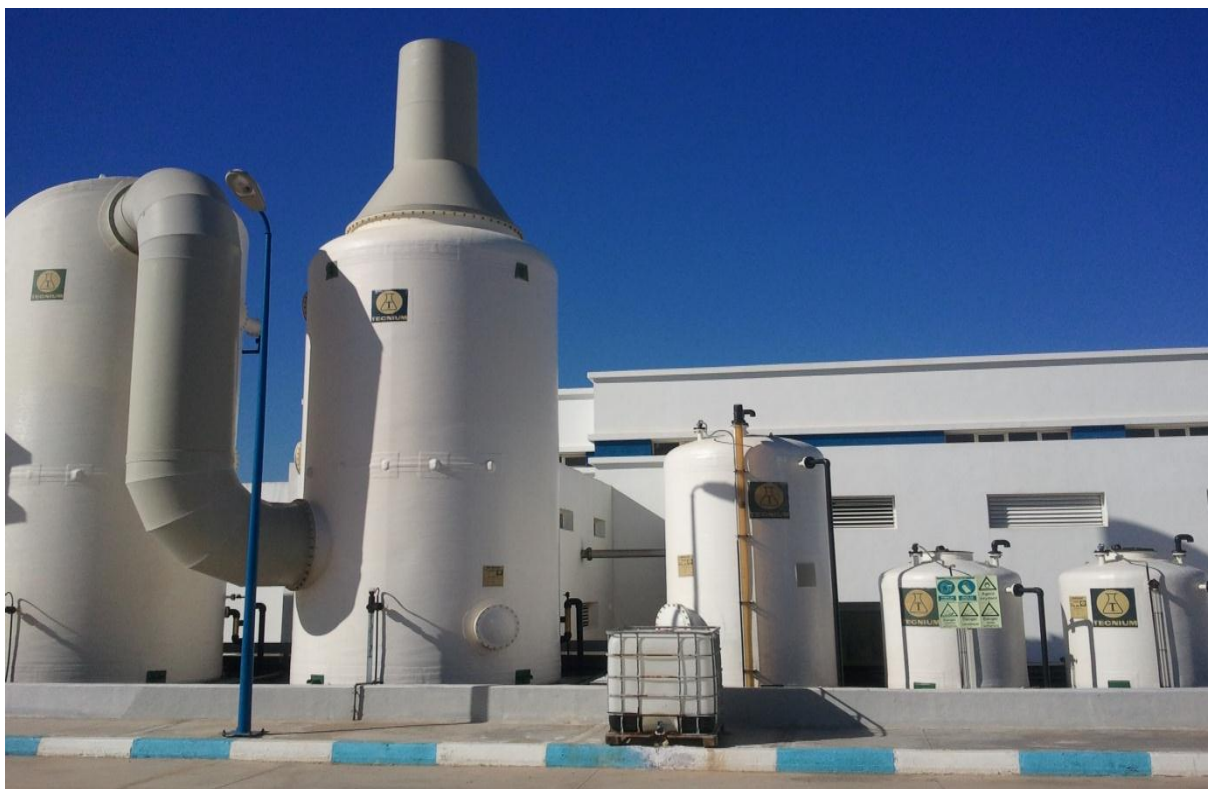
Figure 13: filière de traitement des odeurs de la gauche à droite: Tour de lavage acide, basique, citernes de stockage de javel, acide sulfurique et soude.
