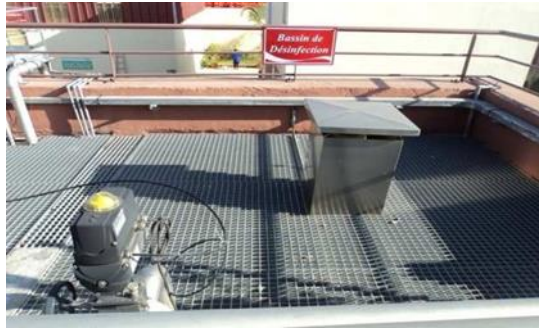
Figure 9: bassin de désinfection
