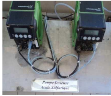
Figure 15 : Pompes doseuses d'acide sulfurique
