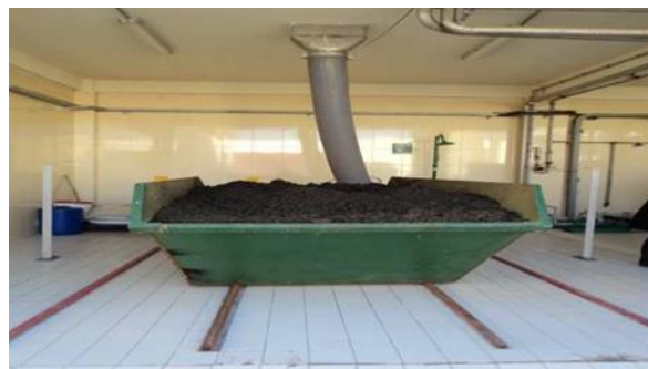
Figure 13 : bac des boues déshydratées
