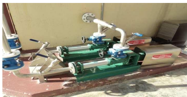
Figure 11: pompes d'extraction des boues
