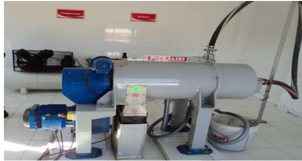
Figure 12: centrifugeuse des boues
