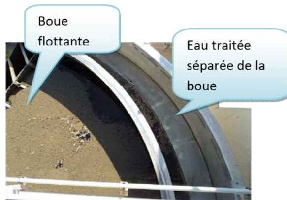
Figure 8 : le flottateur la séparation de l'eau traitée des boues
