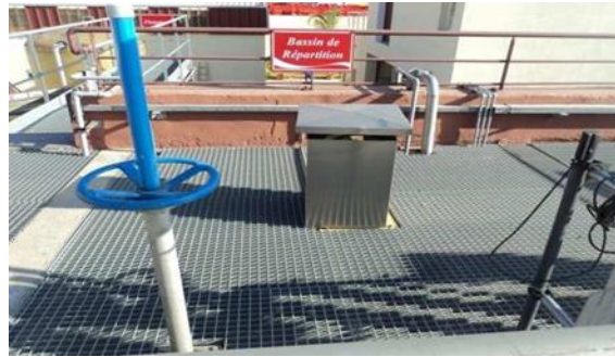
Figure 5 : bassin de répartition de la STEP de la CBGN
