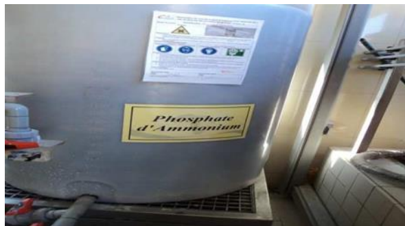
Figure 17 : conteneur du phosphate d'ammonium
