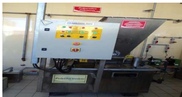
Figure 18 : station de préparation du polymère
