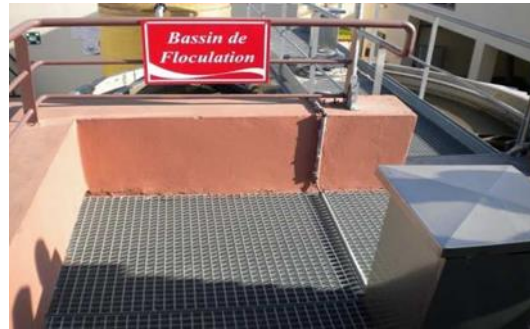
Figure 7 : Bassin de flocculation de la STEP de la CBGN
