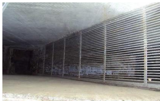
Figure 2 : dégrilleur grossier de la STEP de la CBGN
