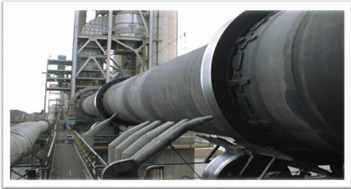
Figure 6 : Four rotatif de la cimenterie de Fès
