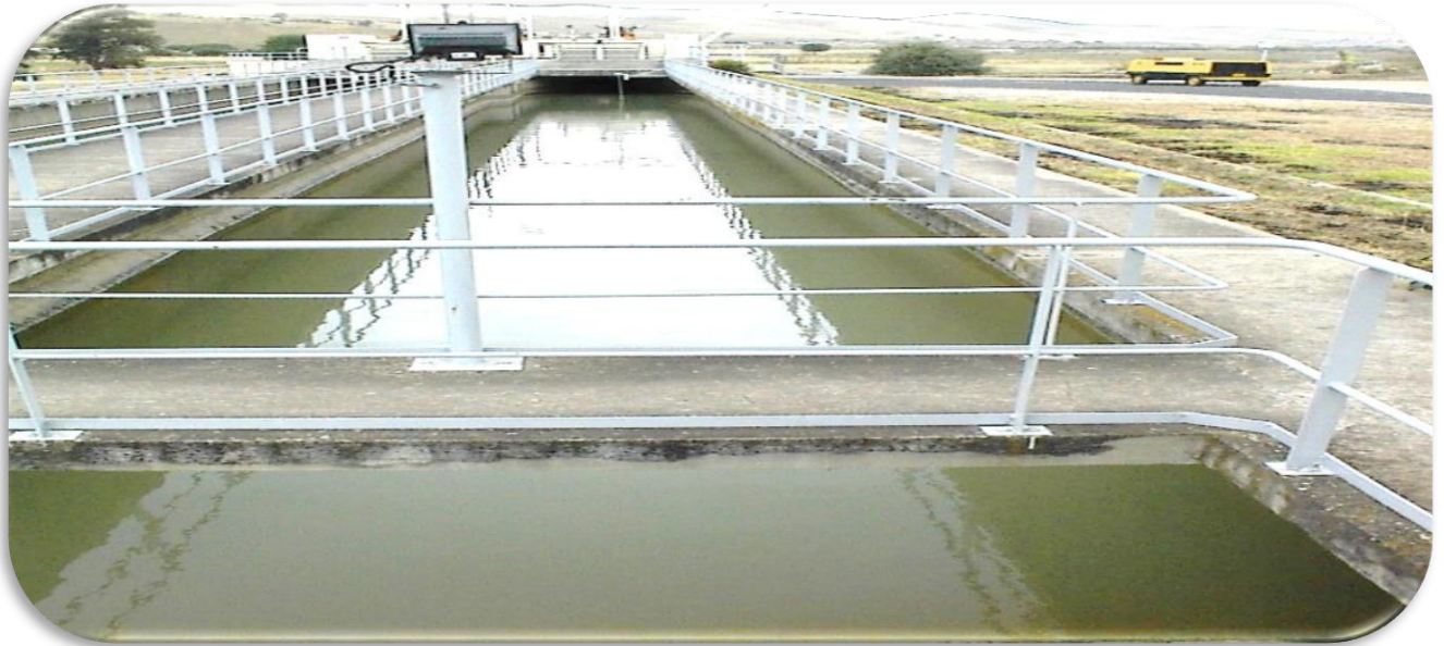
Figure 4. Photo du désableur ( grit)
