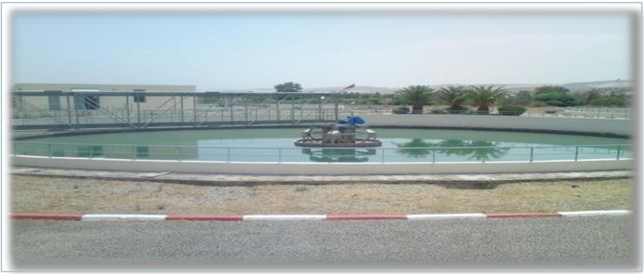
Figure 5. Photo du débourbeur (rack)
