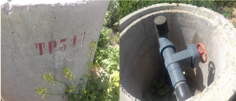
Figure 12: Tête de puits
