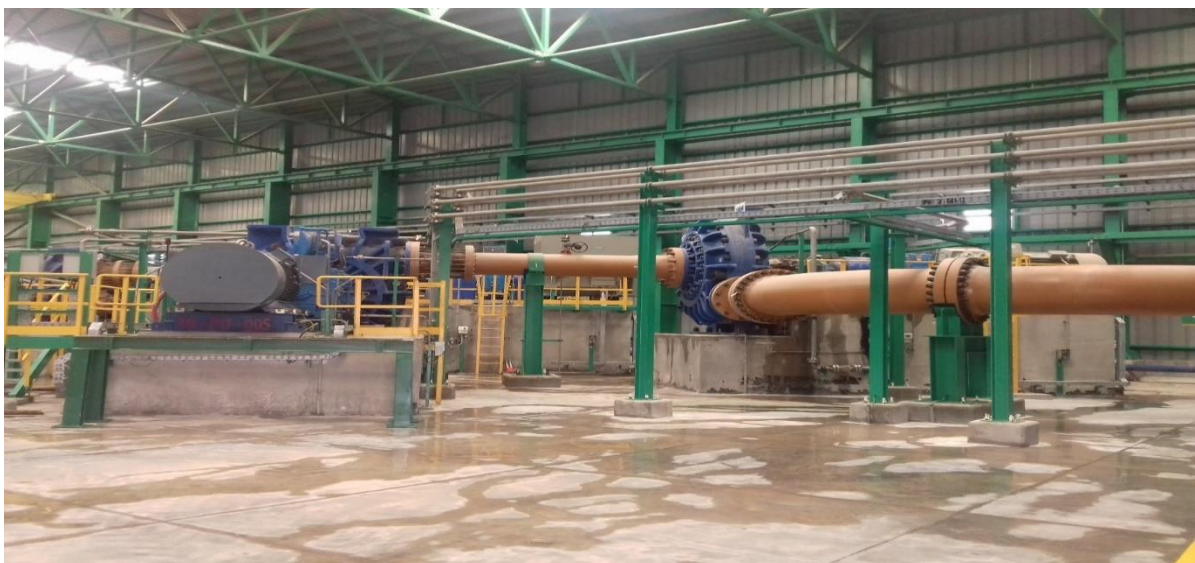
Figure 12 : trains de pompage
