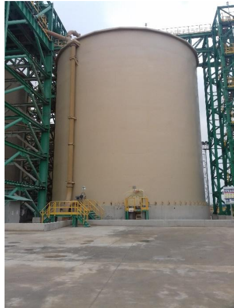
Figure 5: Réservoir de stockage
