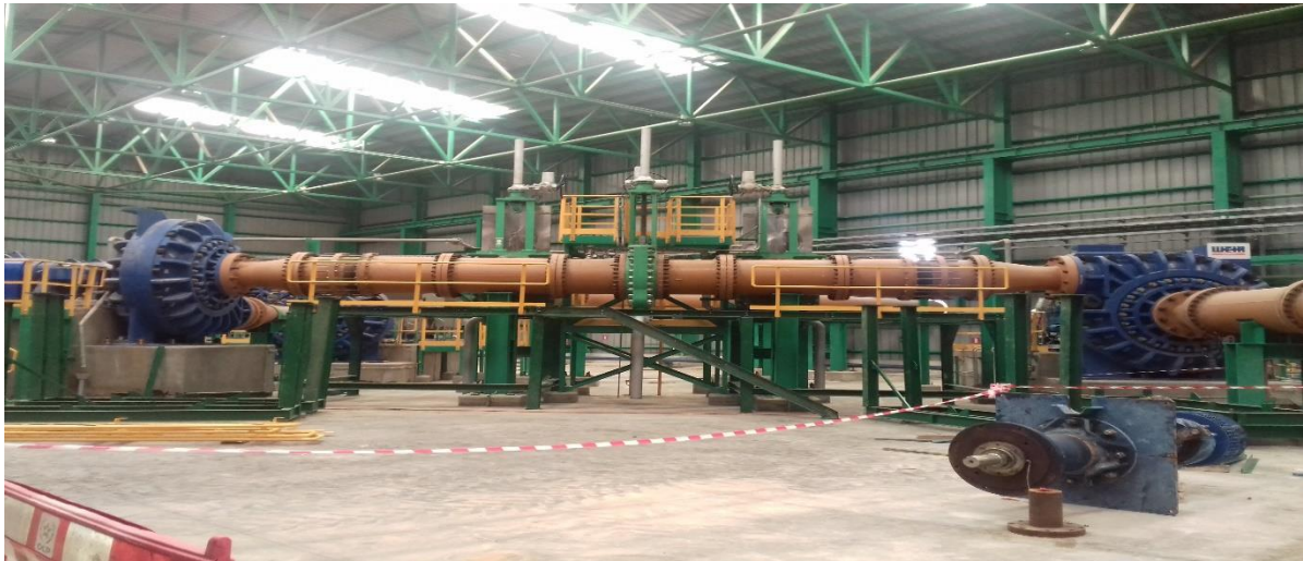
Figure 6 : train de pompage
