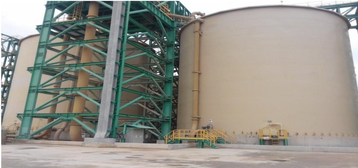
Figure 11 : Réservoirs de stockage au niveau de la station de tête
