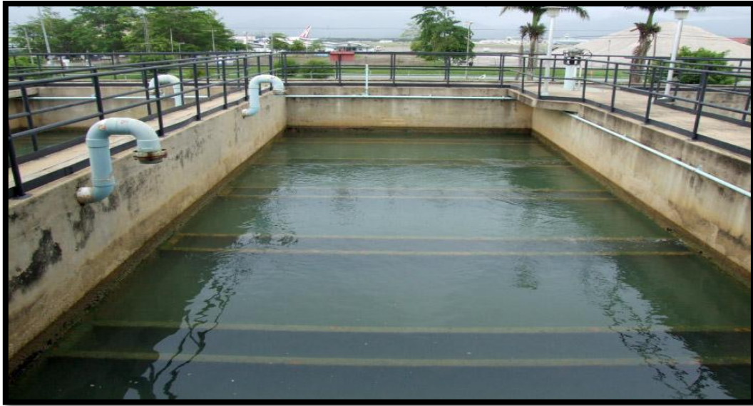
Figure II. 4: Filtre à Sable
