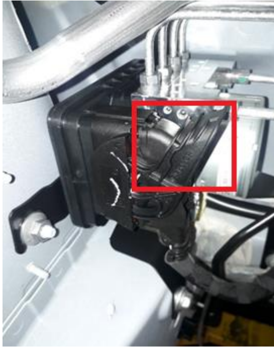
Figure 4 Exemple d'un connecteur mal branché (verrouillage non engagé)
