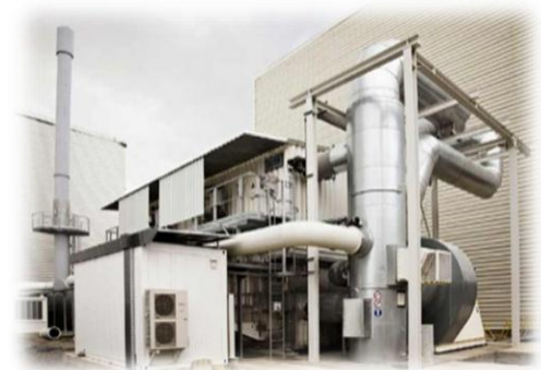
Figure (3-2) : station de traitement des émissions atmosphériques
