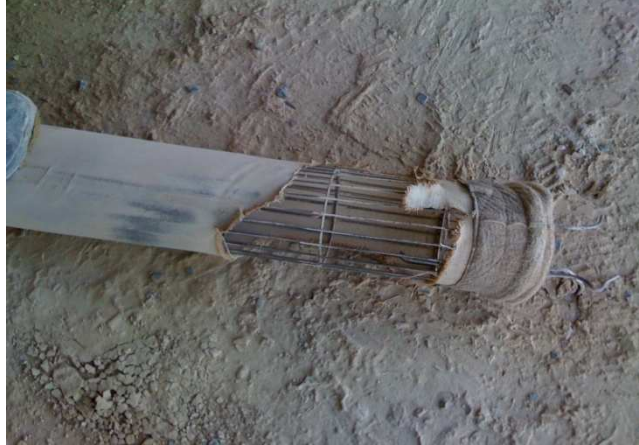
Fig. III.5 : Photo d'une manche brûlée.
