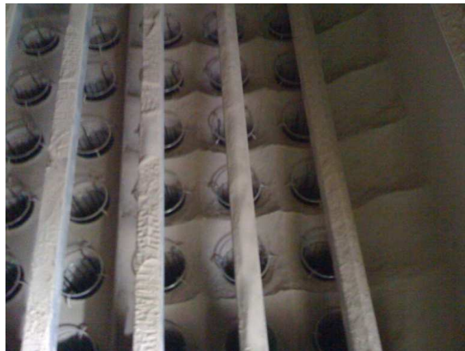
Fig. III.7 : Photo de la répartition de la poussière dans le caisson d'air propre.
