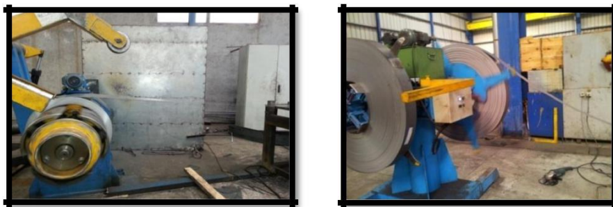
Figure 6: Feuillard déposé sur l'axe du dérouleur-machine tube 1
