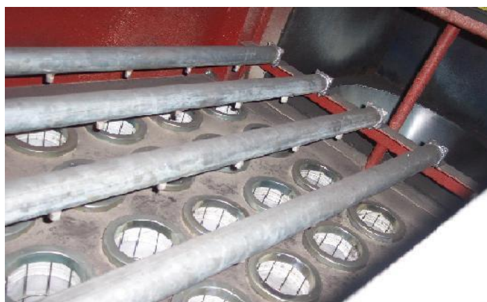
Figure 7 : compartiment air filtré.
