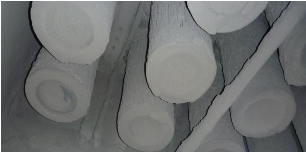
Figure 9 : exemple de manches colmatées.
