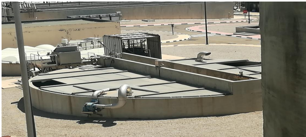
Figure 11 : Bassin des boues non digérés
