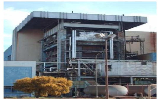
Figure 26: Image réelle de la chaudière
