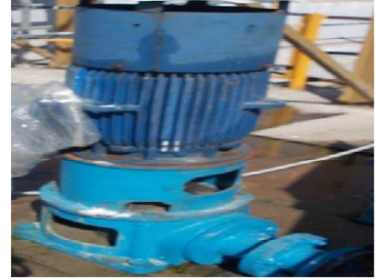
Figure 20 : Image réelle de la pompe lavage grille
