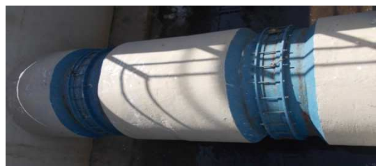
Figure 16 : Image réelle de la conduite
