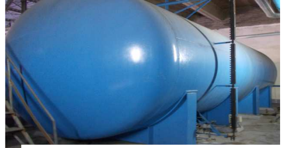
Figure 12: Image réelle de la bâche tampon
