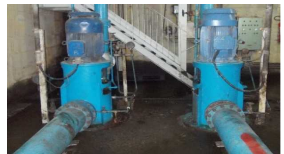
Figure 8 : Image réelle des pompes d'extraction
