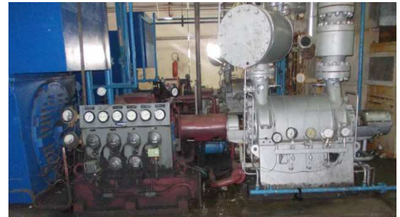
Figure 13 : Image réelle de la pompe alimentaire
