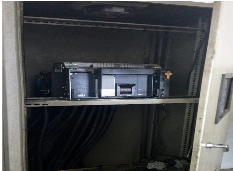
Figure 6:Le Disjoncteur général au niveau du transformateur.
