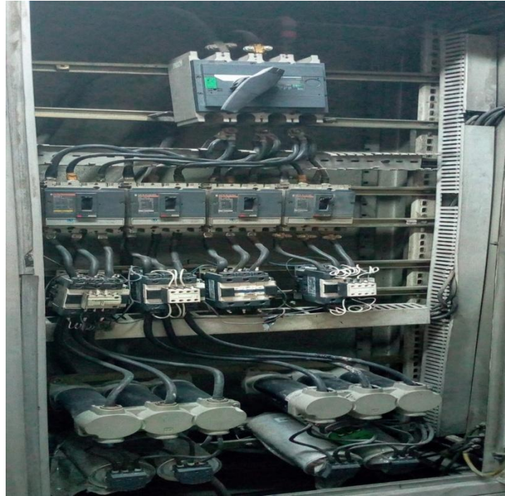
Figure 12: Armoire des batteries de condensateurs au niveau du TGBT
