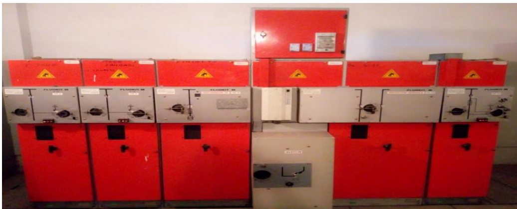
Figure 5: L'armoire du poste en cellules
