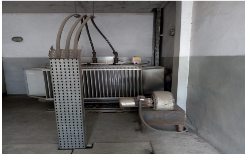
Figure 4: Le transformateur de la société
