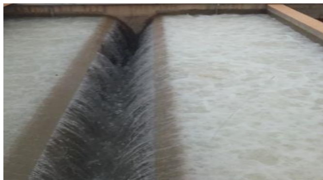
Figure 15 : lavage des filtres
