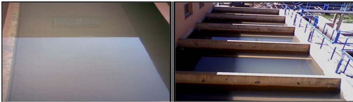
Figure 14 : filtres à sables
