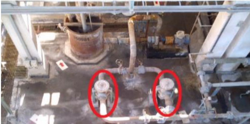
Figure 33: Deux crépines en parallèles installées pour le filtrage d'eau de lavage toile
