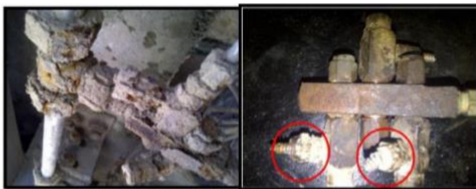
Figure 35:Injecteur et raccords corrodés
