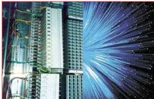
Figure 3 : Armoire réseau électrique
