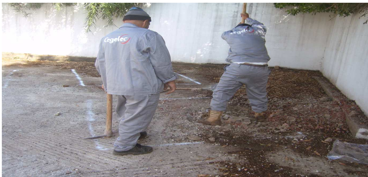
Lancement des travaux d'excavation (l'excavation prend en général 5 jours et selon la nature du terrain)
