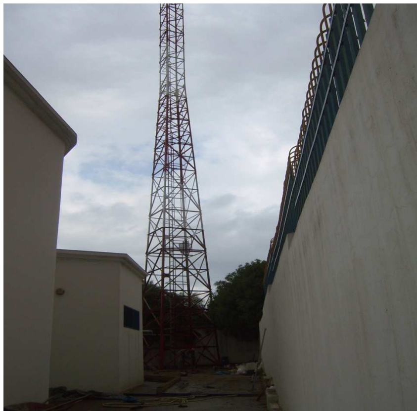
Peinture pylône terminée (étape suivante : installation accessoires (balisage, mise à la terre..) puis nettoyage du site : 1 journée)
