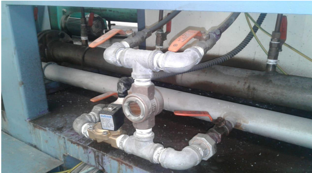
Figure 31: électrovanne de commande
