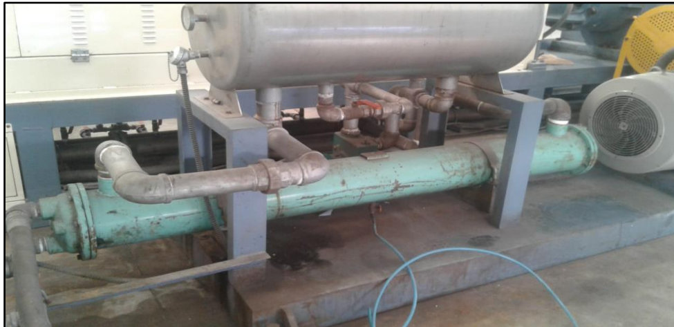
Figure 20: L'échangeur de chaleur
