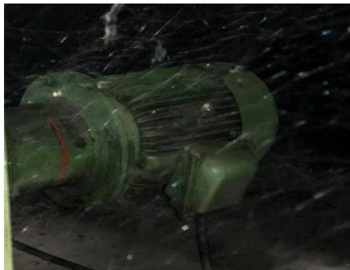
Figure 22: moteur asynchrone du system de main œuvre.
