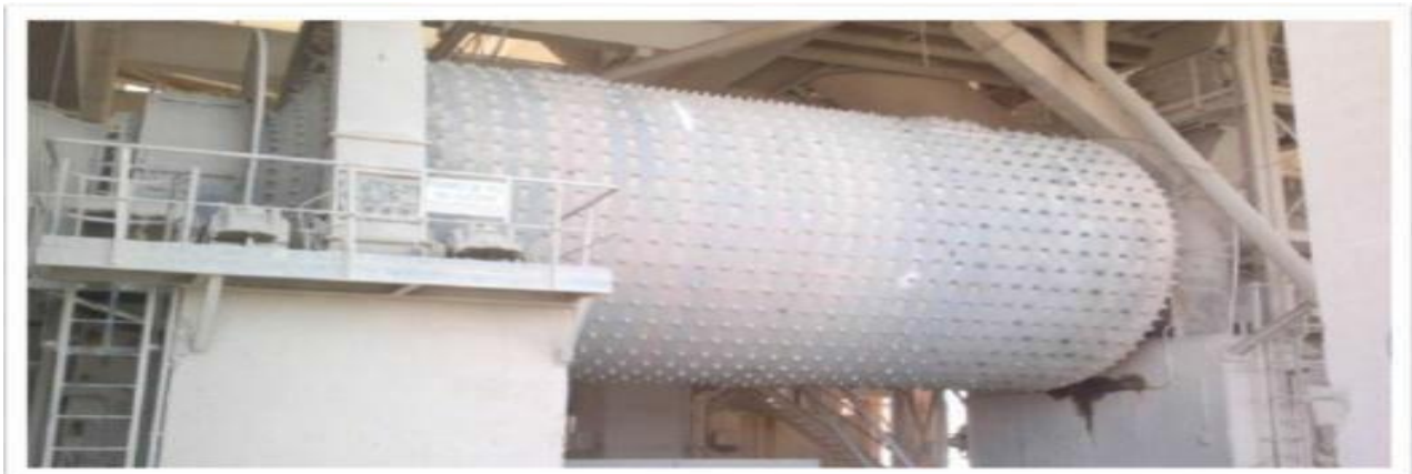
Figure 6 : Broyeur de matière crue
