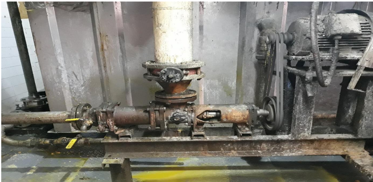
Figure 39 : fuite d'amont d'une pompe
