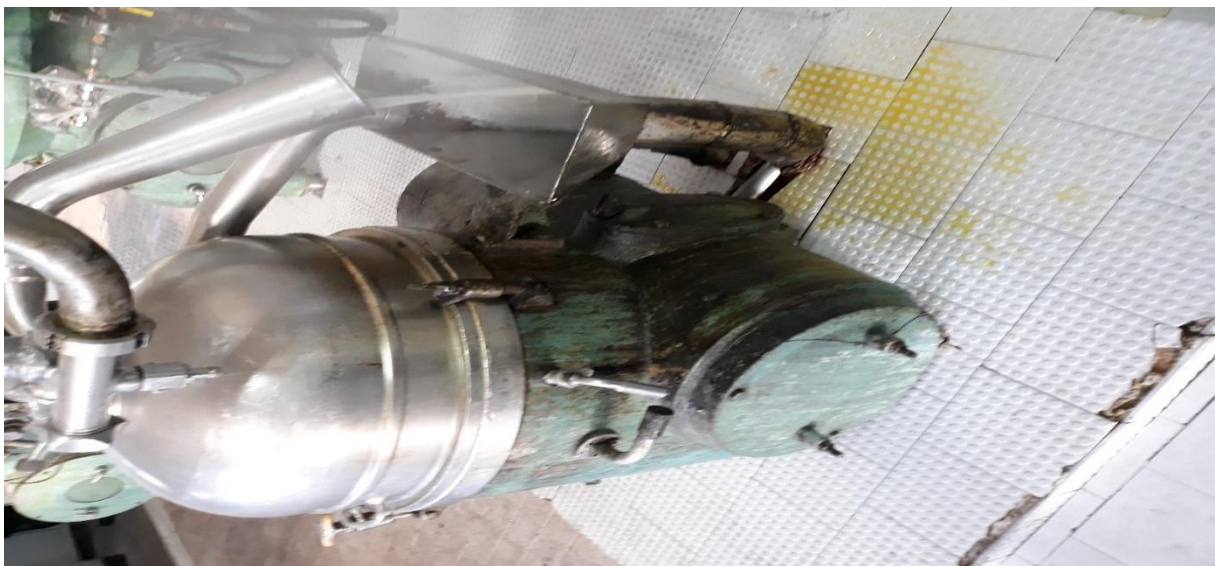
Figure 40 : fuite en armatures du séparateur
