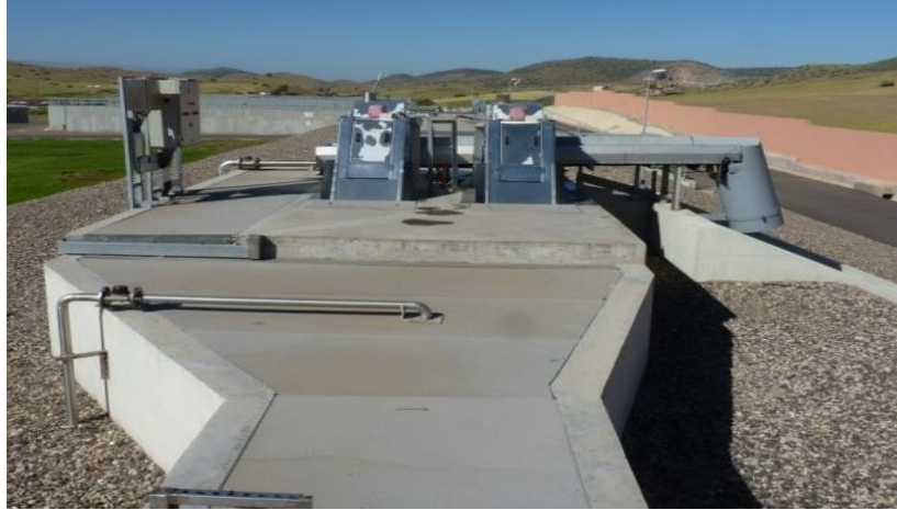
Figure1 : station de prétraitement
