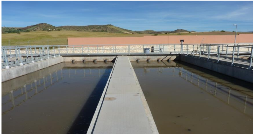
Figure 7: Fosses imhoff-partie de décantation primaire
