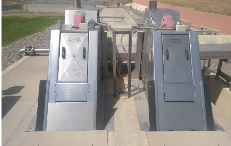
Figure 2: dégrillage des eaux usées
