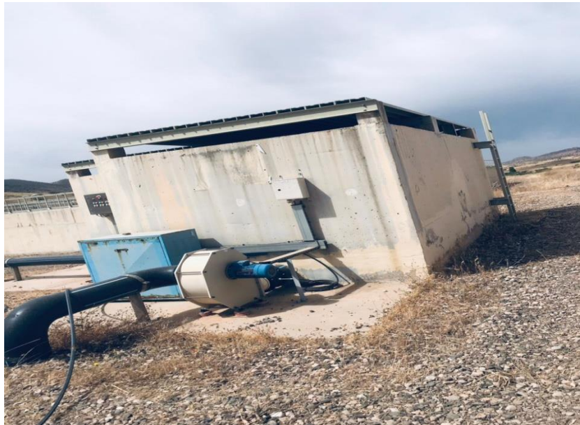
Figure 12 : Station de désodorisation
