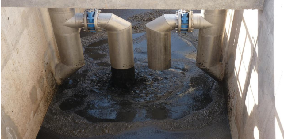
Figure10 : Extraction des boues digérées
