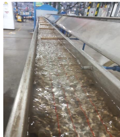
Figure 46: bac de refroidissement
