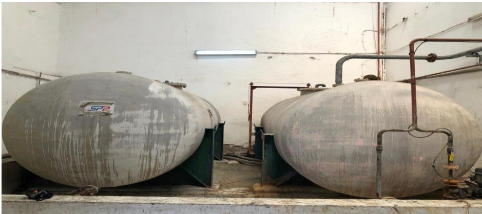
Figure 9: Réservoir d'acide sulfurique.
