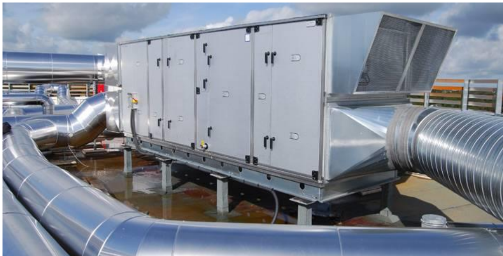
Figure 73 : Centrale de traitement d'air.
