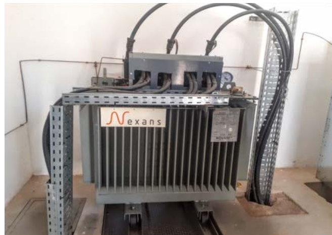
Figure 5: Transformateur de puissance
