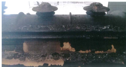
Figure 16 : Photo de la cellule protection endommagée
