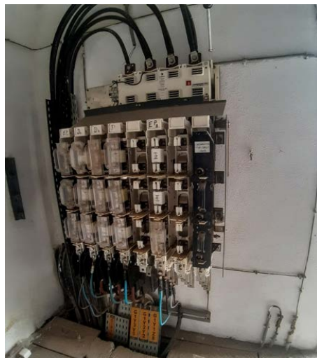
Figure 6 : Tableau Général Basse Tension
