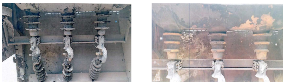
Figure 16 : Photos des cellules endommagées
