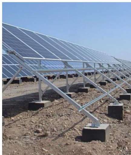
Figure 16: Support métallique des panneaux solaires.
