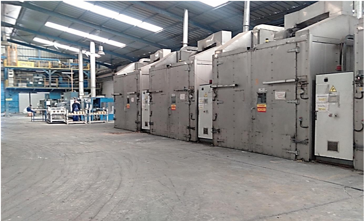
Figure 13: Chambres de murissage ou hydrosetting
