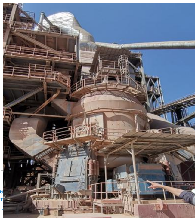
Photo 4 : Broyeur de cru (l'usine de LafargeHolcim Fès 2022)
