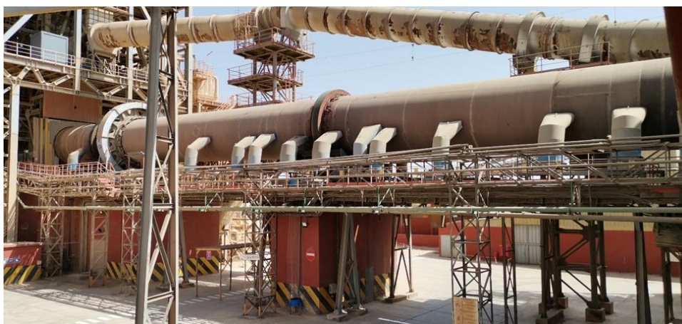
Photo 8 : Le four rotatif (l'usine de LafargeHolcim Fès 2022)
