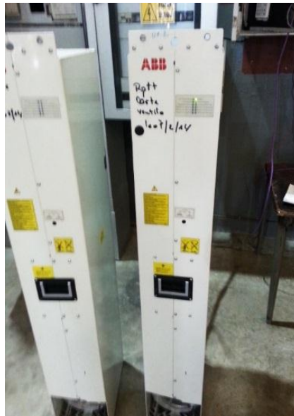
Figure 37 : Modules redresseurs ABB
