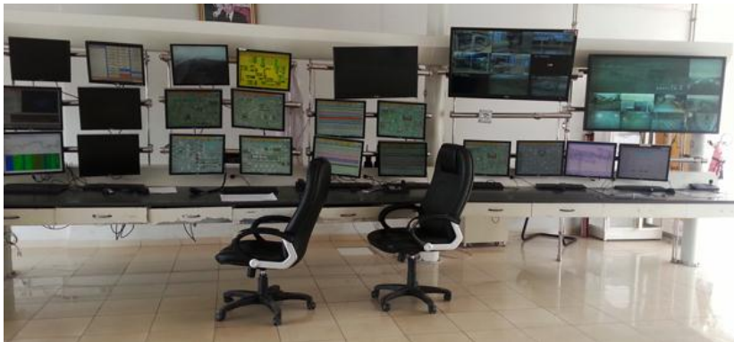
Figure 4 : Salle de contrôle
