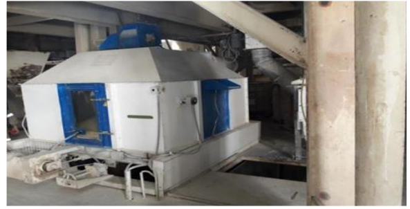
Figure 7: Photo d'un refroidisseur
