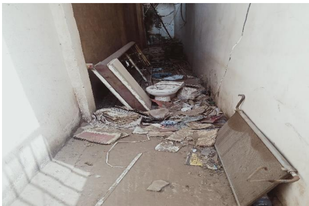
Figure 6: Ordures à côté des murs
