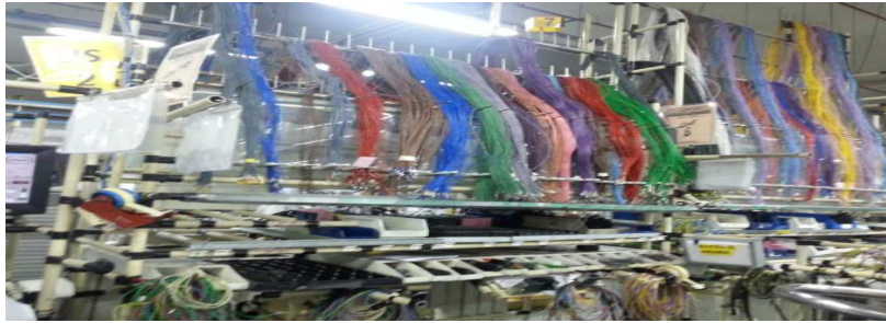
Figure 27 : L'état de la cellule 6
