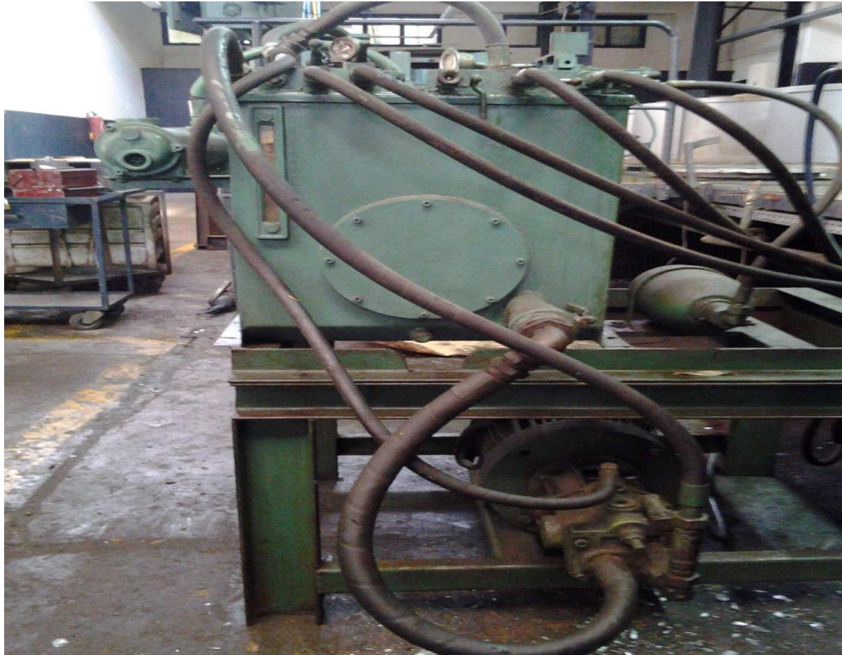
Figure 13 : Groupe hydraulique de la coquilleuse
